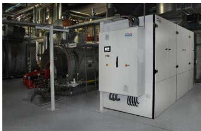
▲ Abbildung: YADO|KWK Erdgas BHKW im Heizhaus
